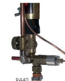
R440 détail sécurité brûleur sonde + veilleuse
